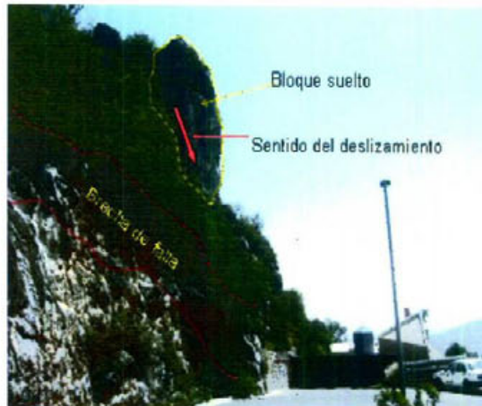
Fotografía 15. En el Cerro de La Corona, aparecen brechas que rellenan una falla, y un gran bloque en posición inestable; todo lo cual conforma una situación de alto riesgo.
